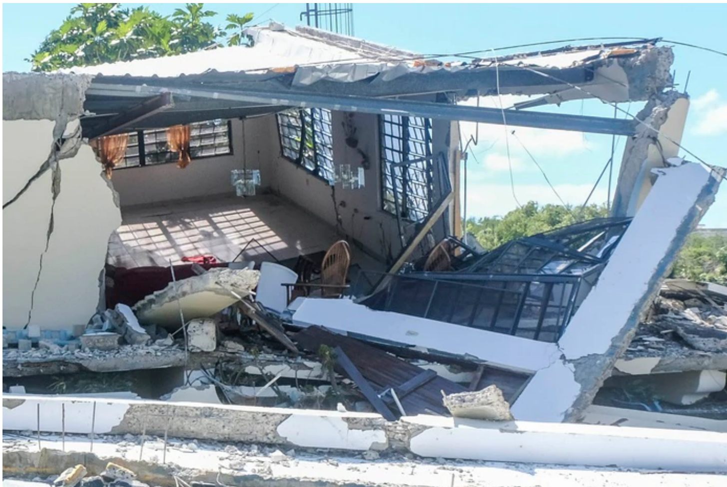
Vivienda destruida por los terremotos en Guánica. (gerald.lopez@gfrmedia.com)
